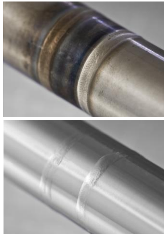
Rohrleitung geschweißt aus Werkstoff 1.4435 Unbehandelt (oben) und chemisch gebeizt und passiviert (unten); Verfahren V HC 700
